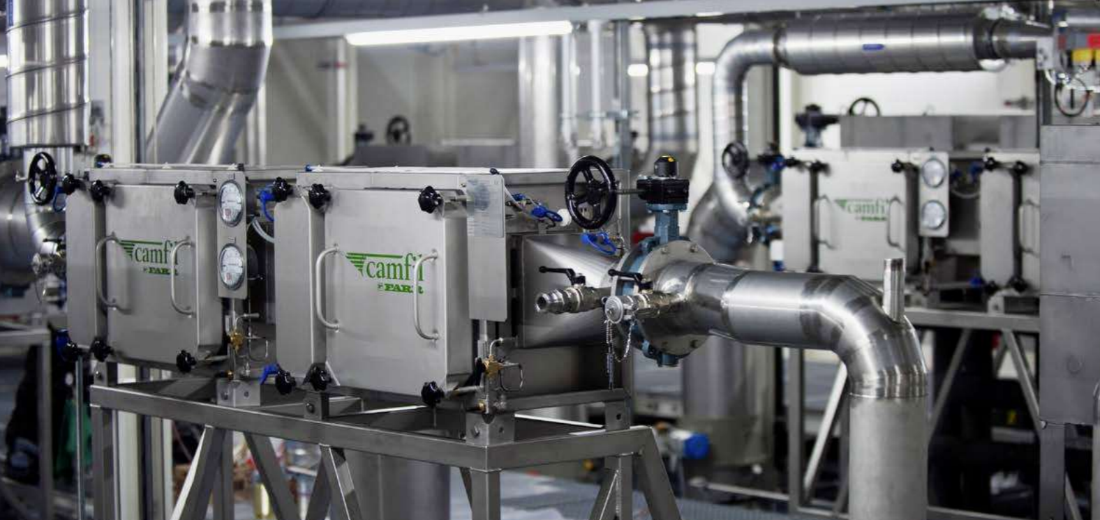
Teilansicht Filtersysteme der Lüftungsanlage
