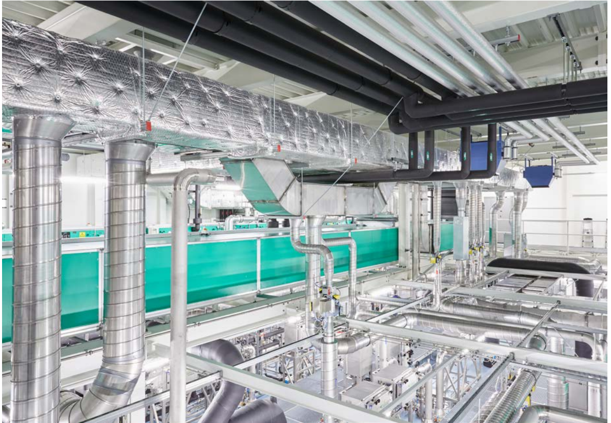
Lüftungsanlage des Biosicherheitslabors in Spiez.
